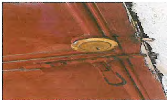
Foto 2: SUSTITUCIÓN EN CHAPA EN PUERTA DE AULA 2
