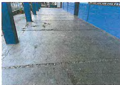
Foto 4: BARANDA EN CORREDOR INCOMPLETA Y CAUSA PELIGRO.
