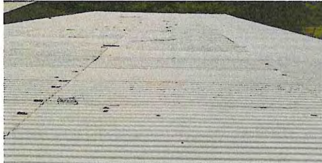
Foto 2: Techo en exterior, agujerado.
